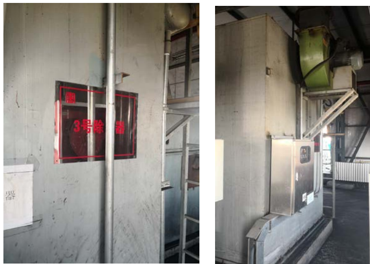
图11 3号除尘器（2号筒仓）
