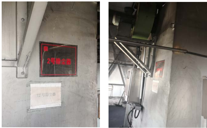
图10 2号除尘器（1号筒仓）
