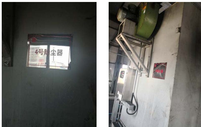
图12 4号除尘器（2号筒仓）
