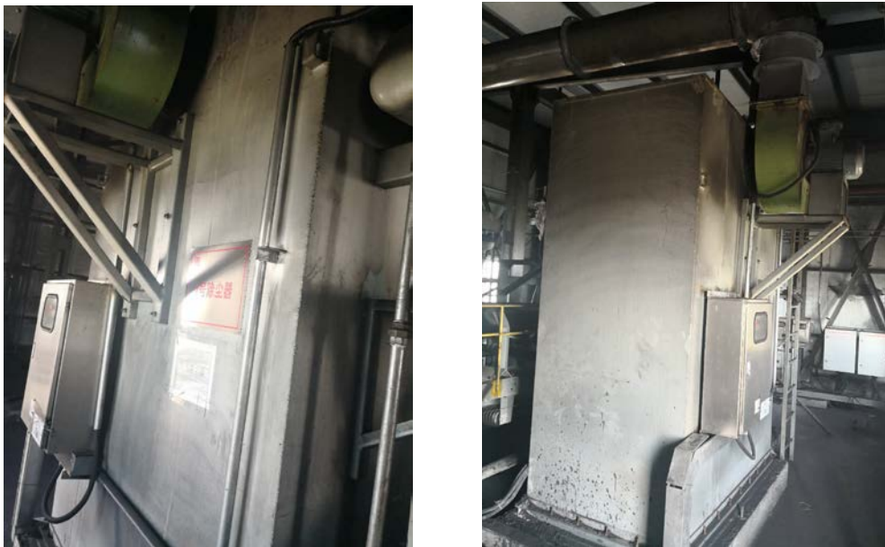
图 9 1 号除尘器（1 号筒仓）
